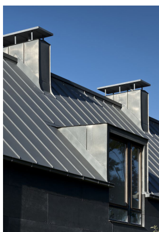
Kviste i samme plan som facade og Skorstene som samlekasser til afkast. (§ 9.8, 9.11 og 9.12)
