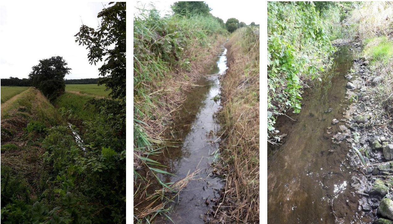
Foto 1-2: St. 2000-2800. Vandløb dybt nedskåret beliggende mellem marker. Enkelte træer giver skyggevirkning.
