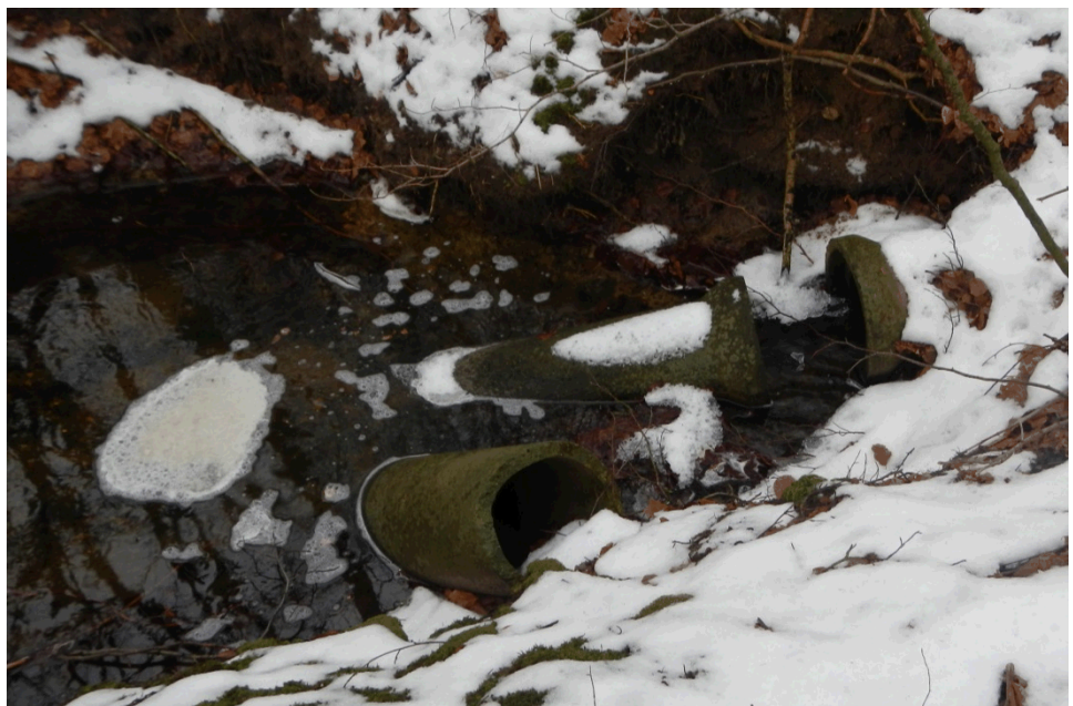
Figur 3-5: Udløbet fra brønden på nedstrøms side af Denderupvej (foto 04-02-2014).
