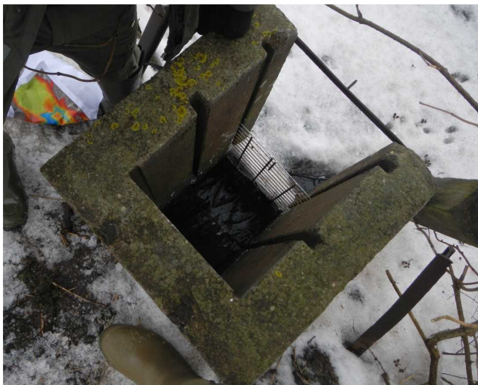
Figur 3-1: Stigbordet er opbygget af en betonkasse med træplader. Der er monteret en rist for at undgå grene i afløbet (foto 04-02-2014).
