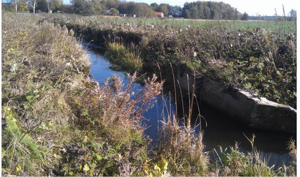
Figur 2-6 Gammel rest af brofundament er ved at skride ud i vandløbet.
