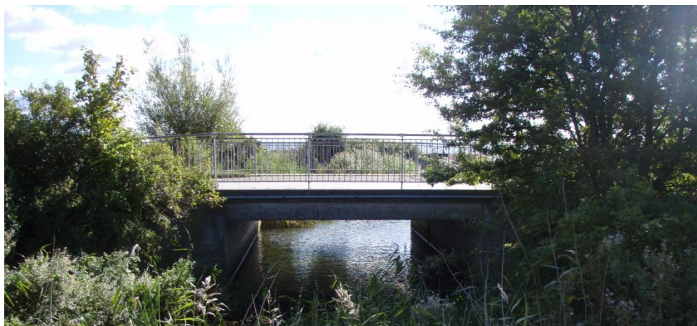
Figur 4-5 Broen ved udløbet af Faxe Å, har en begrænsende effekt på indstrømning til det lave område ved stormflodshændelser, og vil oversvømmes ca. ved kote 2,0m.
