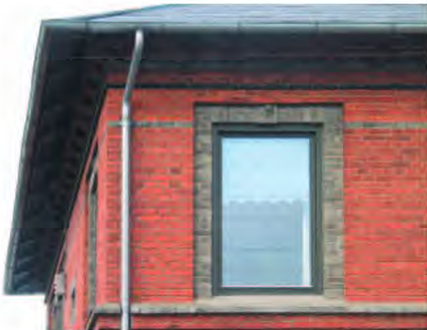
Mange af byens huse er igennem tiden blevet forsynet med sprosseløse vippevinduer med termoglas. Vinduerne respekterer ikke husenes stilart og oprindelige dekoration som på dette foto.
