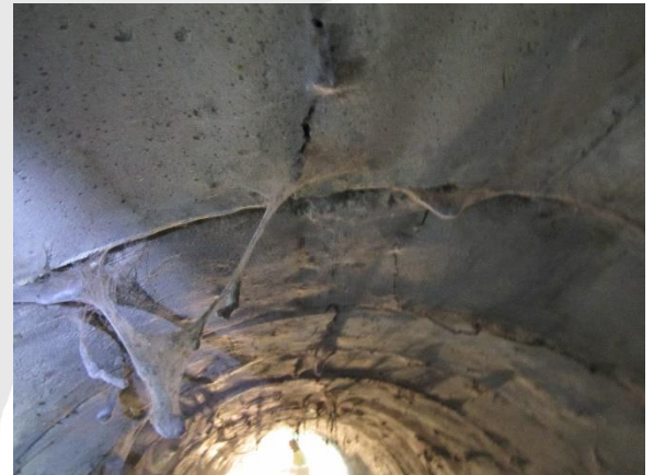
4. Brudrevner i de underførte betonrør
