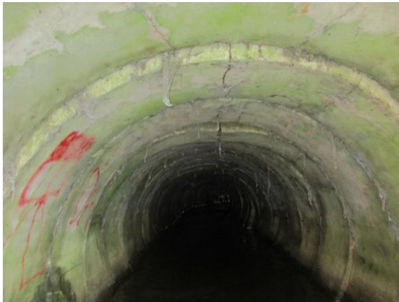
3. Brudrevner i de underførte betonrør
