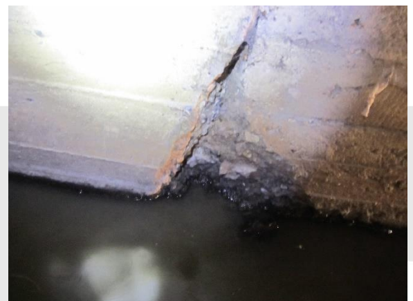
6. Underskylningsskader på bygværket
