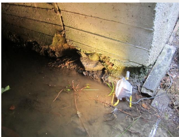
5. Underskylningsskader på bygværket ved indløb
