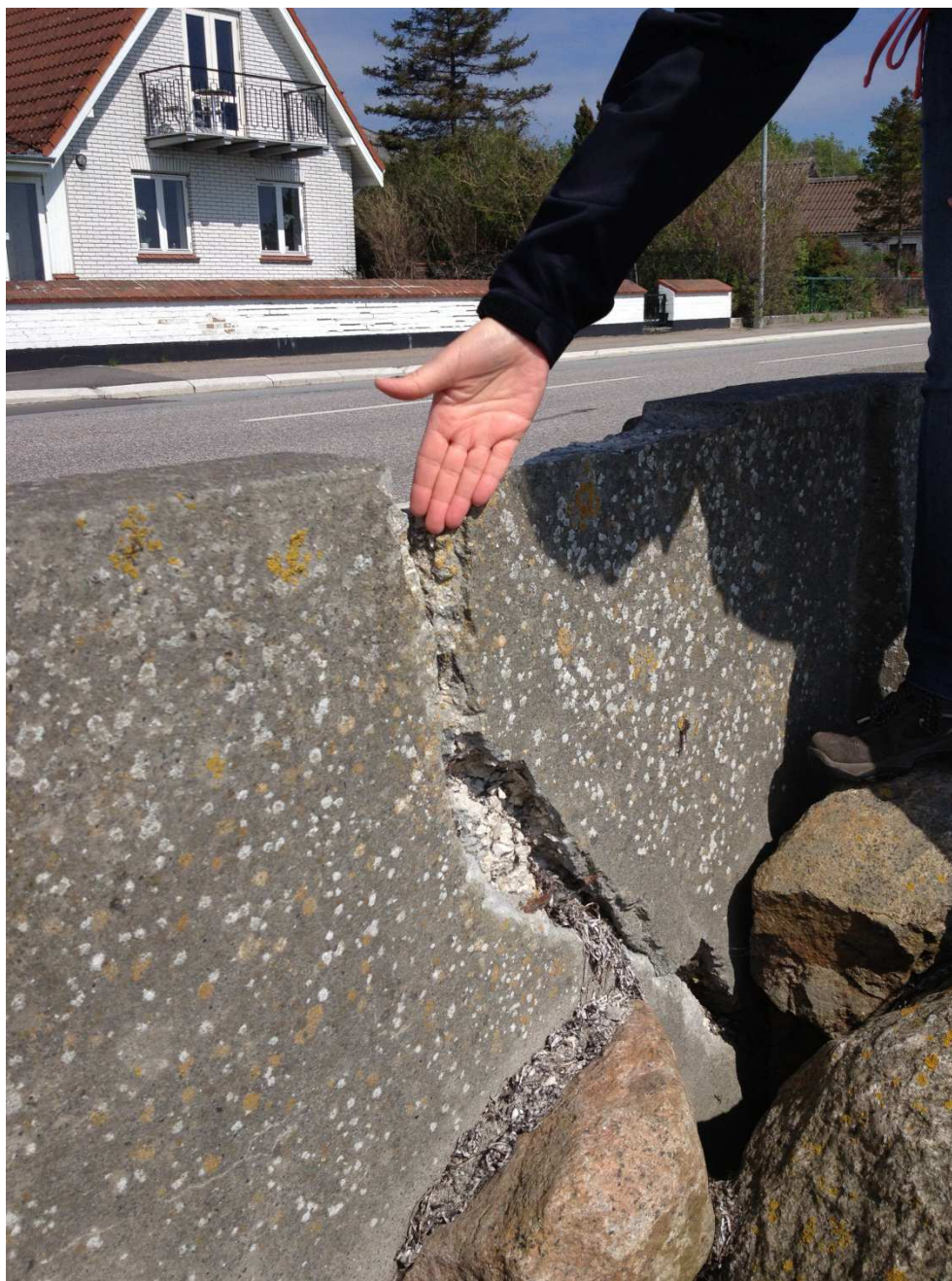
Figur A.7 Beskadigelse af støttemur.
