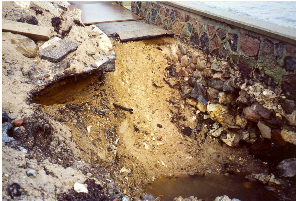
Figur 2.16 Hul i Strandvejen efter sydøsten storm i 2002, forårsaget af hul i støttemuren og som konsekvens deraf underminering af vejen.
