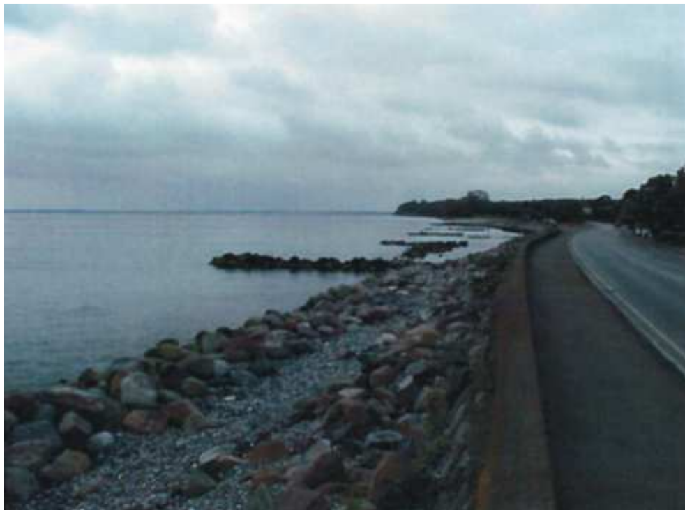
Figur 2.10 Stranden sydvest for havnen i 2001 hvor der er udlagt en stenrække til beskyttelse af muren.
