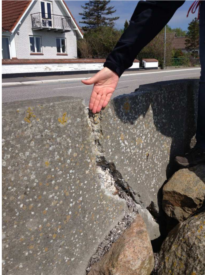
Figur 4.3 Beskadigelse af støttemur.
