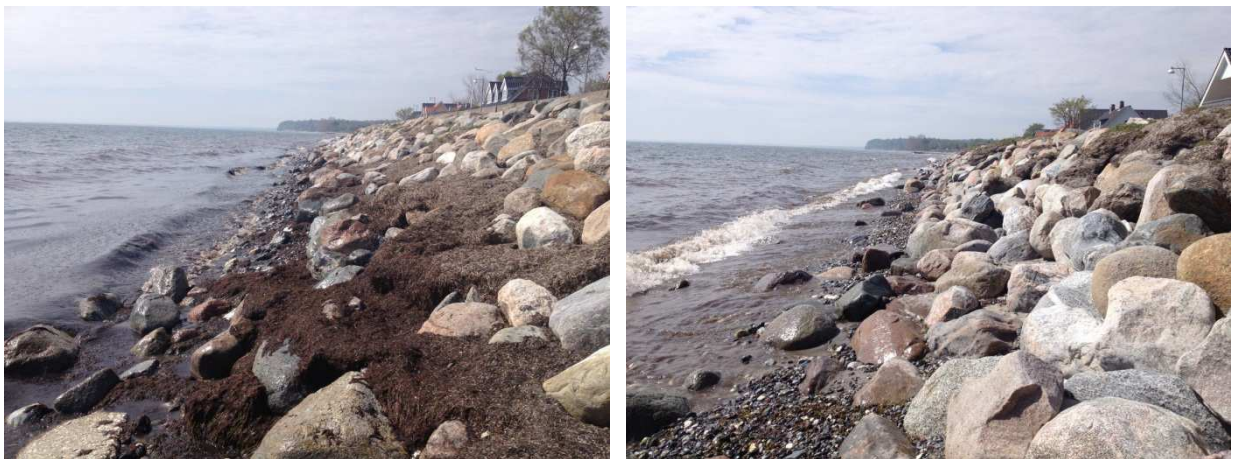
Figur 4.2 Enkelte dæksten faldet ned fra stenkastningen.
