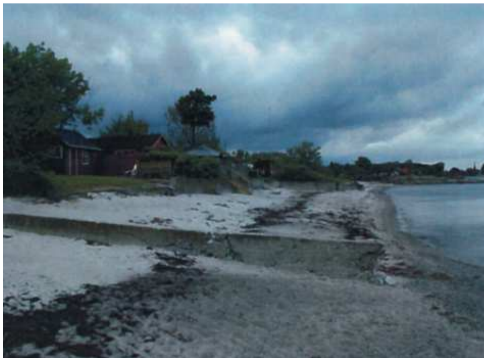
Figur 2.13 Stranden sydvest for Faxø Å ud for Rosendal Godsets sommerhuse i 2001. Der ses et fremspring i betonstøttemuren og en nedbrudt høfde.
