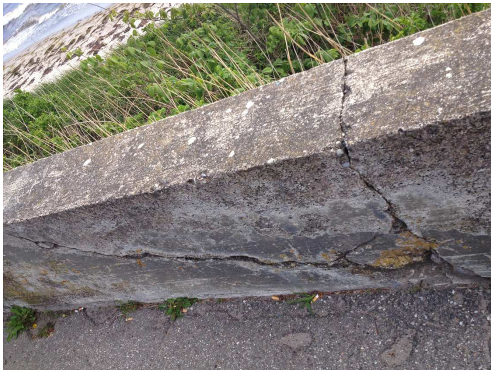
Figur A.26 Beskadigelse af støttemur.
