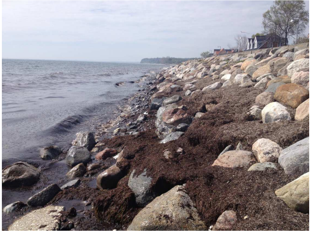
Figur A.5 Enkelte dæksten faldet ned fra stenkastningen; ud for hus nr. 18 på Strandvejen.
