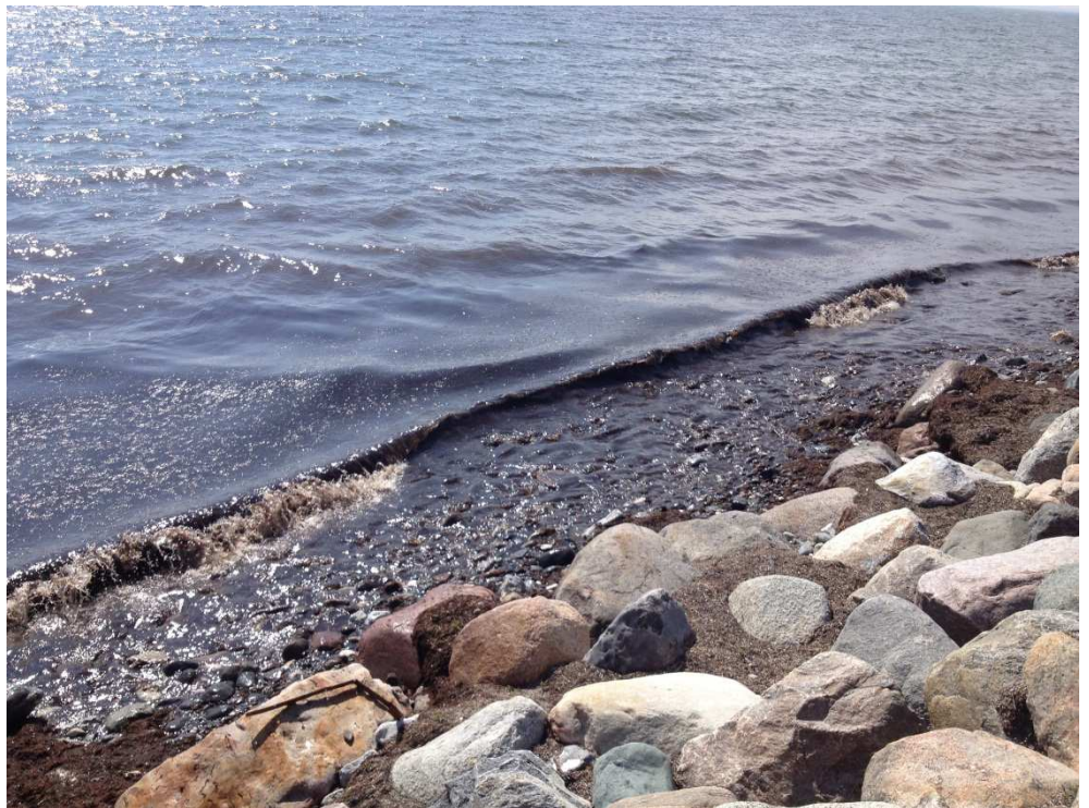
Figur A.6 Strand foran stenkastning er væk. Tåen af filterstenene ses i vandkanten.
