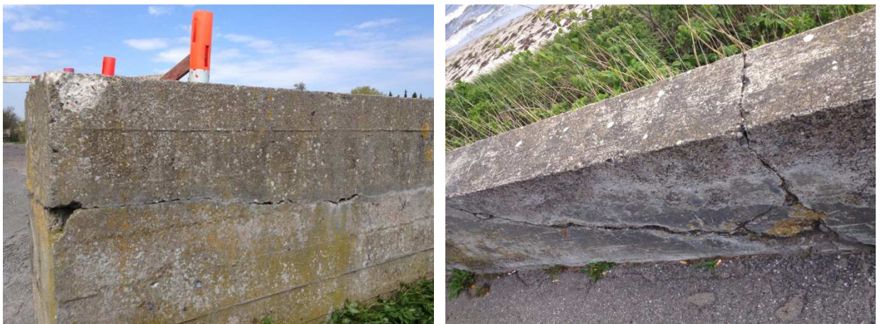
Figur 4.4 Beskadigelse af støttemur, Område 4.
