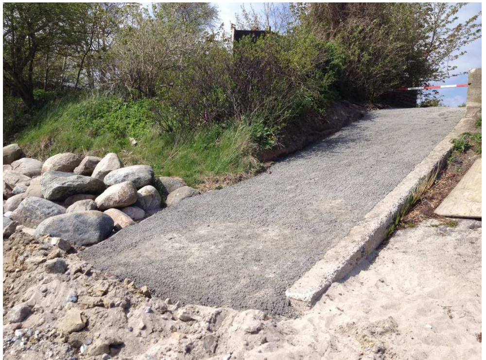
Figur A.23 Nyrenoveret nedk rselsrampe. Strandniveauet er sunket foran rampen, s  der er blevet efterfyldt p  stranden med en blanding af sand og sten.
