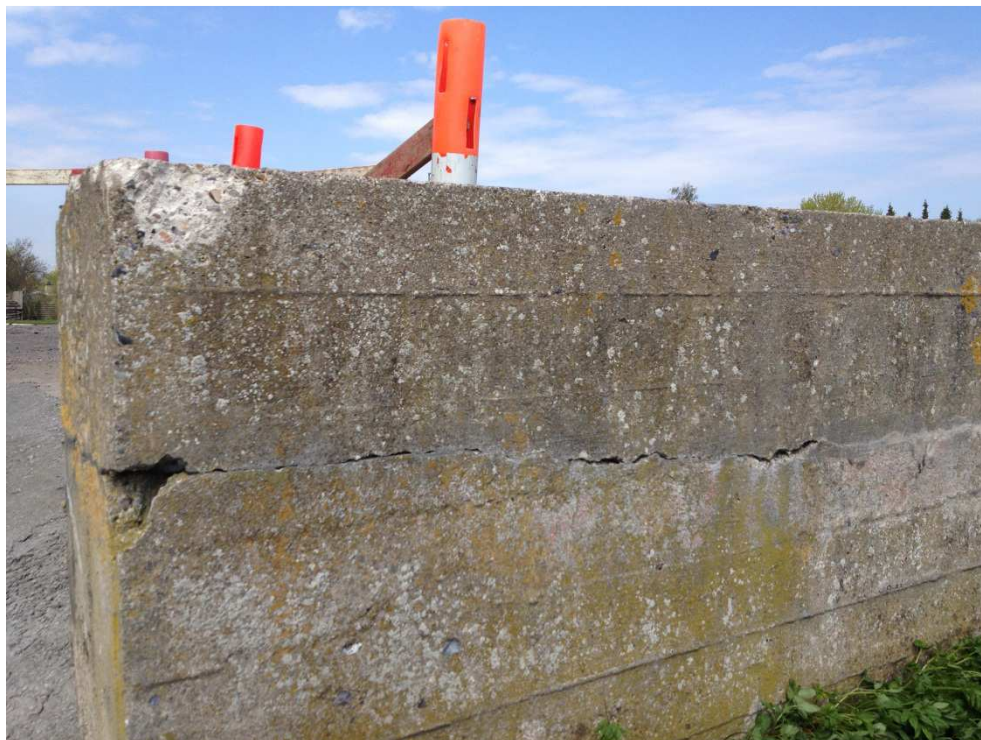
Figur A.24 Beskadigelse af støttemur.
